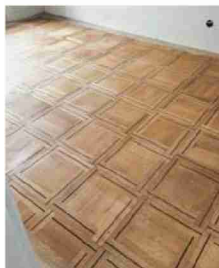
Ein Drittel des Kassettenbodens konnte gerettet werden.
